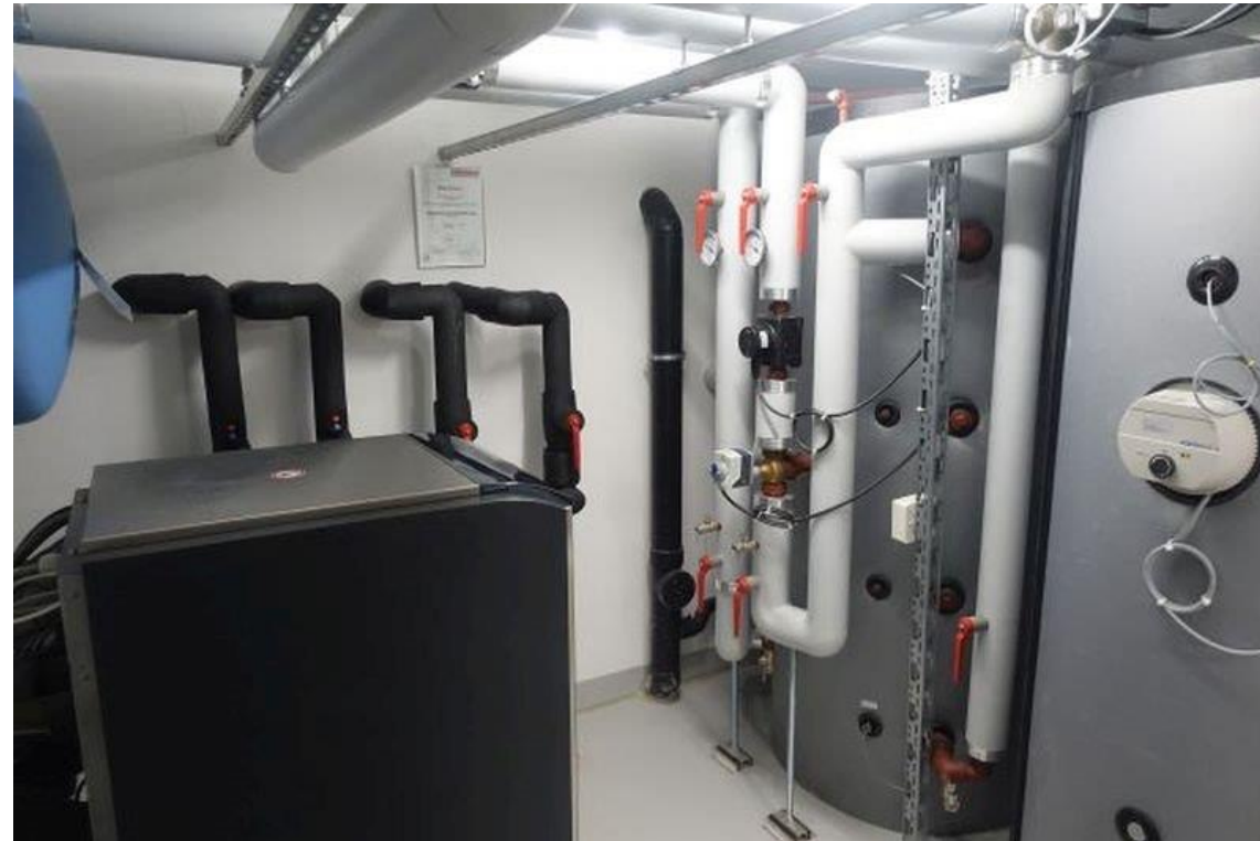
Pilotanlagen im Feld: Mehrfamilienhaus, Horgen 2022 (Rennovation), 1 m 3
